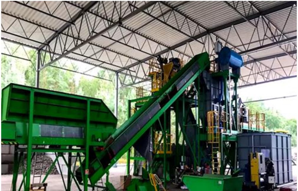
Fotografia 1. Instalacja procesu separacji wodnej
